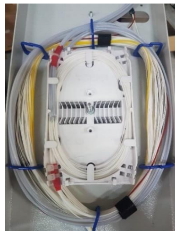
Fot.12 - Owinięty zapas tub kabla liniowego i DAC oraz pigtaili w module dookoła kasety
