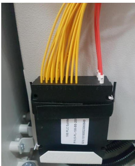
Fot.14 – Zamontowane sprzęgacze w obudowach Black Box
