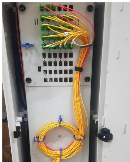
Fot.15 – Patchcords sprzęgacza wprowadzone na pole komutacyjne
