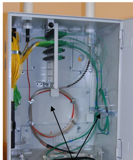
Miejsca nawinięcia nadmiaru długości zapasu włókien kabla stacyjnego oraz pigtaili
