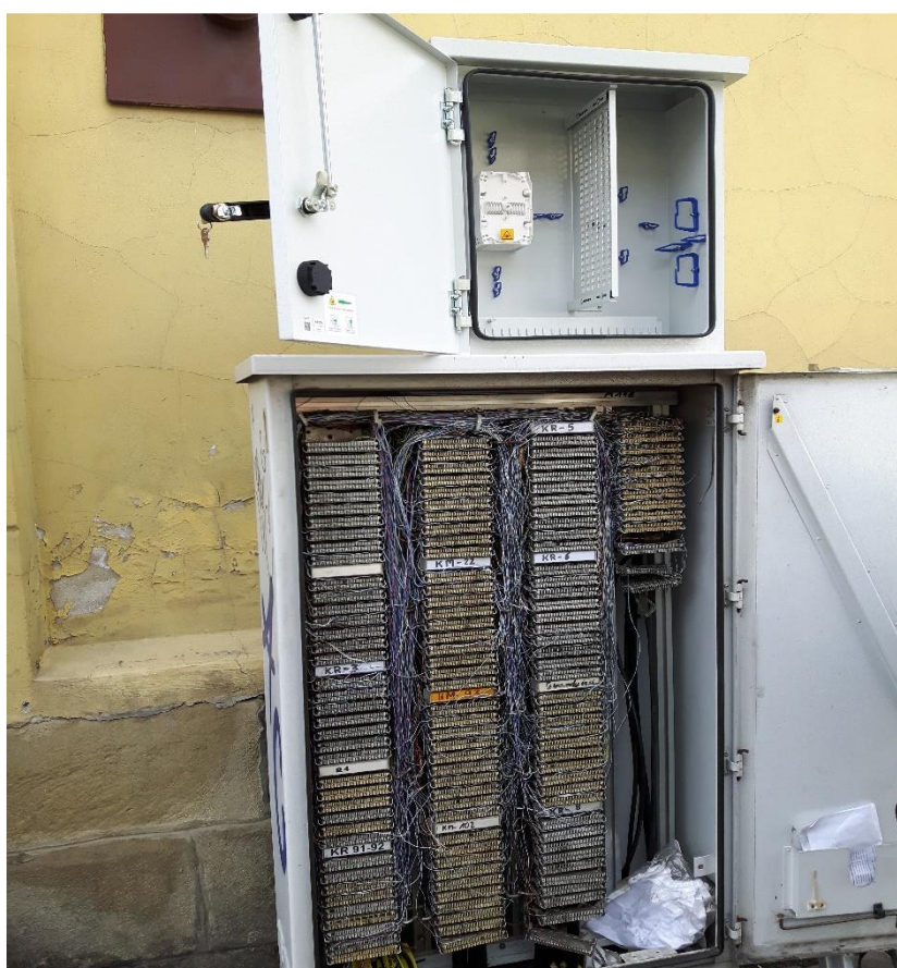
Fot.9 PSB-NH w pełni zamontowana do szafy CU.
