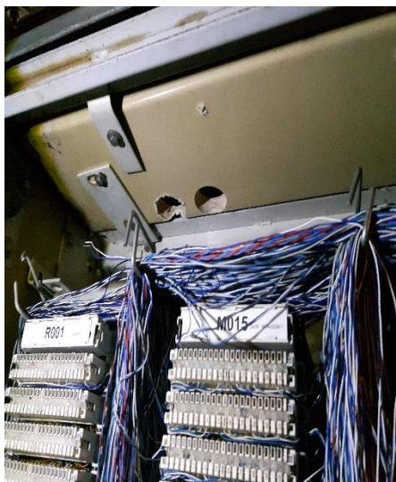
Fot.7 Przebita otworami konstrukcja szafy CU.
