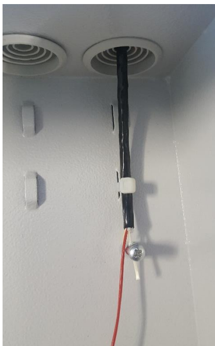
Fot.3 Mocowanie kabla światłowodowego w przełącznicy.
