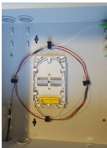
Fot.6 Pole liniowe połączone z kablem dosyłowym
